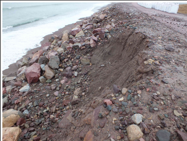
Effondrement aval avant la partie digue
