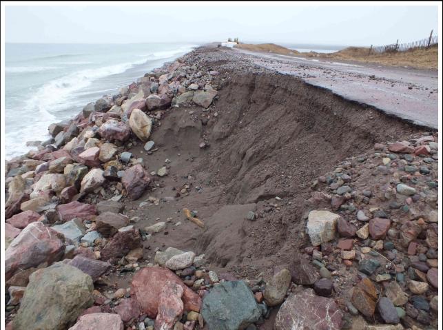
Effondrement entre la partie digue et la plateforme centrale
